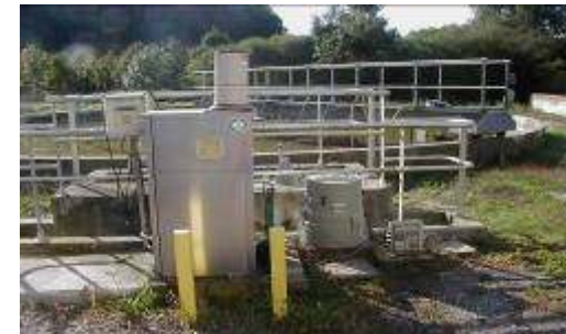
instrumentation mesure et contrôles eaux
