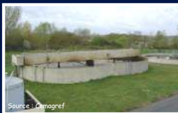
effluents et boues issus des stations d'épuration
