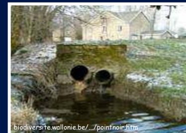
rejets des habitations non connectées aux réseaux
